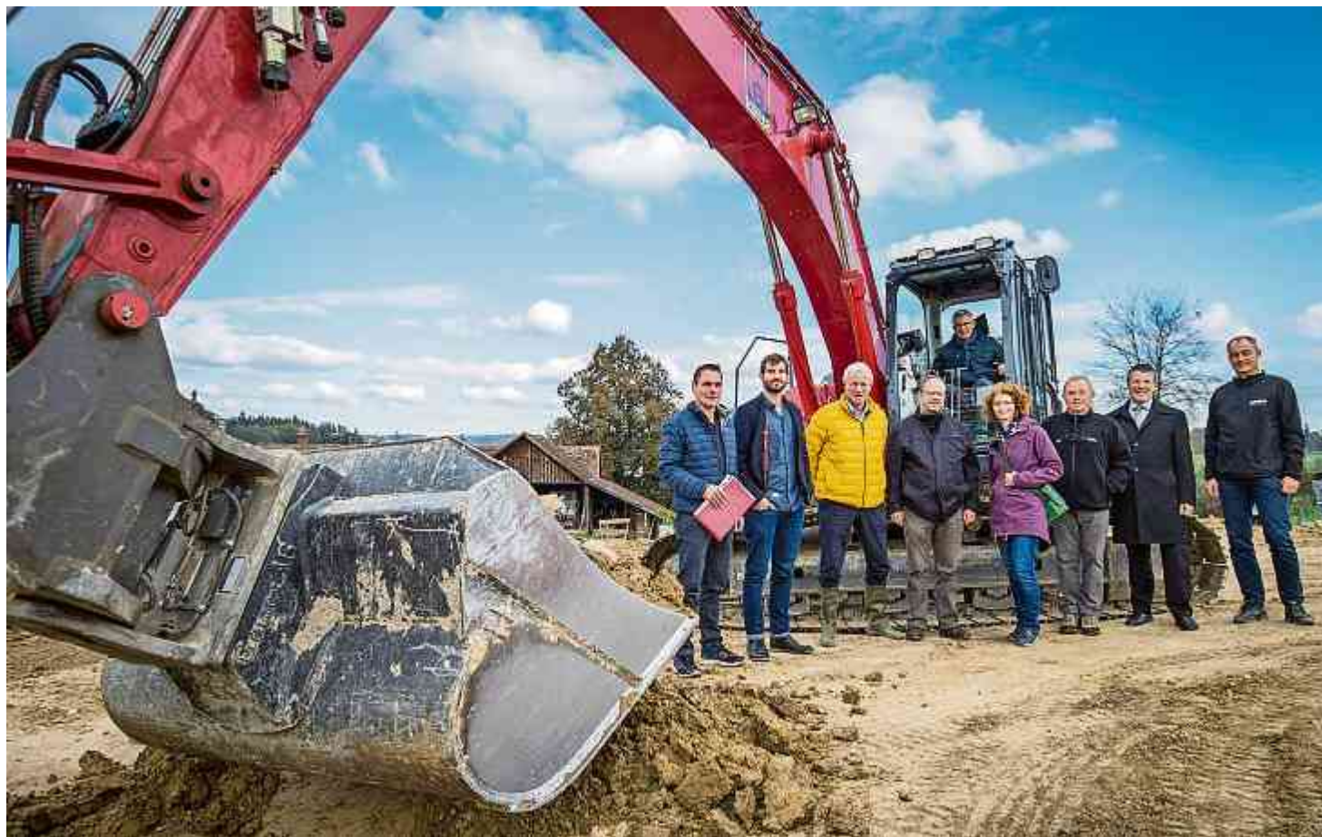
Vizegemeindepräsident Karl Ringenbach steuert den Bagger, davor stehen Vertreter von Behörde, Bauherrschaft und Handwerk. Bild: Reto Martin
